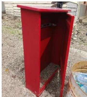
Gambar 5.12 Analisa kondisi hydrant
